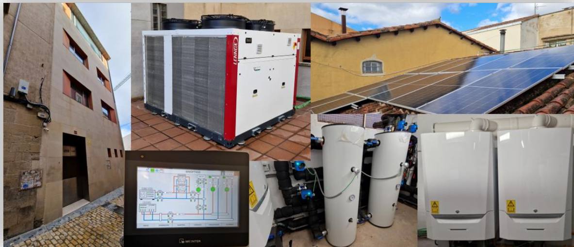
Foto: instalaciones de climatización, iluminación y autoconsumo del edificio de la UNED de Logroño.
